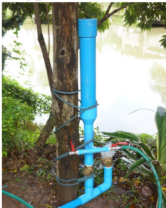
水源落差1.5メートルでの水撃ポンプ テスト
