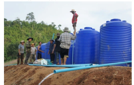
配水管(3ルートに分配+オーバーフロータンク経由配水) 貯水タンク(5基)
