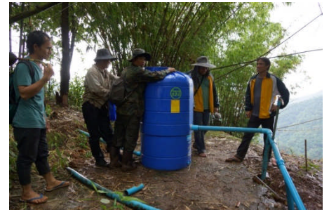
砂除け中継タンク (水源地から3 km)
