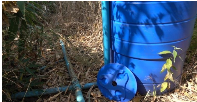
水源地からの中継タンク
