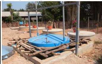
保育園の処理槽とガスタンク
