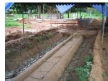
処理水流入槽
