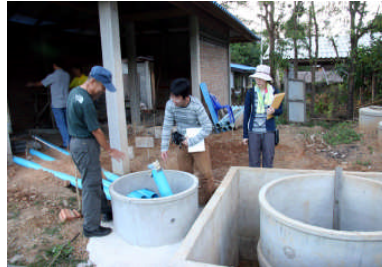
システム入口集合槽
