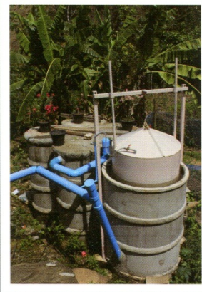
エコトイレ浄化装置
