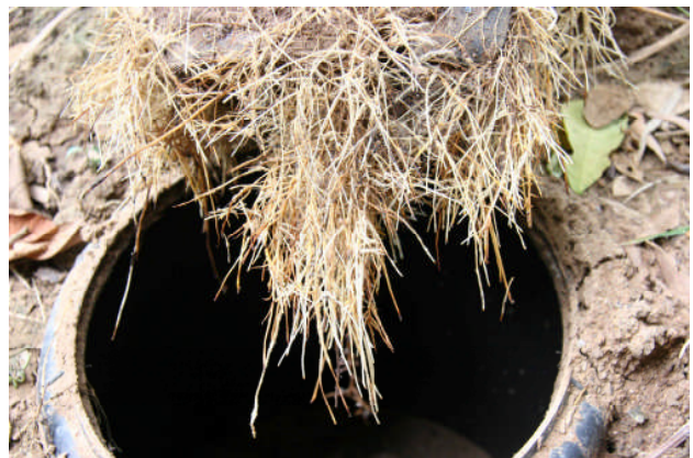
異状に成長した根（消化槽ガス抜き処理部分）
