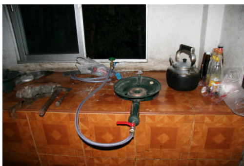
寮の台所ガス設備
