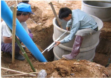
ガス槽パイプ配管
