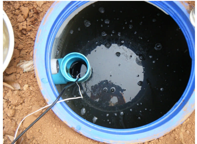
第2嫌気槽の状況
