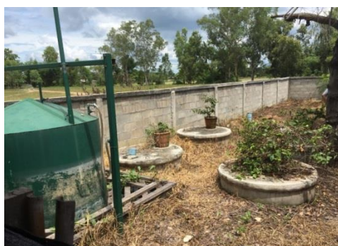
[エコトイレの浄化設備]
